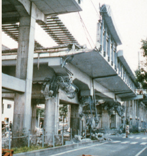
落橋した新幹線高架橋（山陽新幹線）
