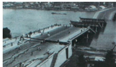
1964年 新潟地震で被災した昭和大橋
