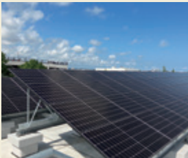
屋上に設置された太陽光パネル
