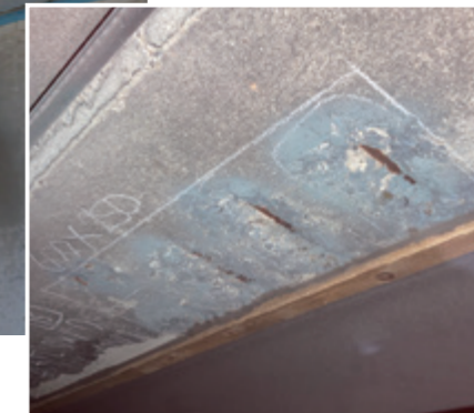
コンクリートはく落状況
